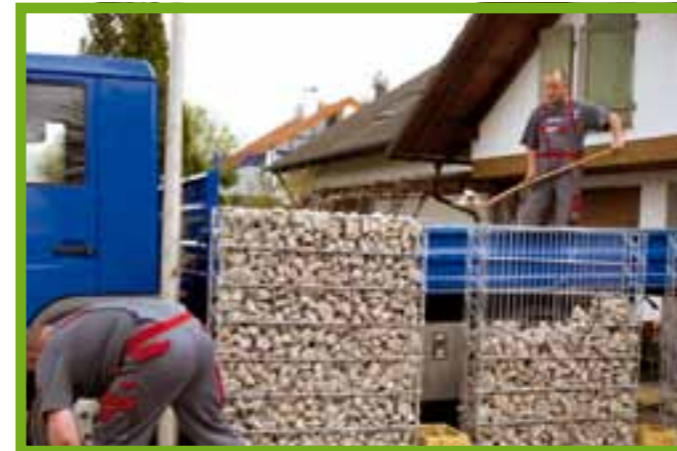
Befüllung der Pergone.
